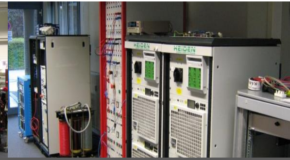
LABOR - DC-TESTQUELLEN & PV VERTEILUNG
