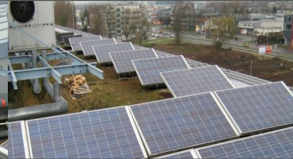
PV INSTALLATION - SÜD-OST
